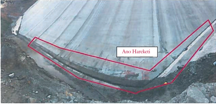
Şekil 8. Barajın Önyüzü Beton Anolarında Deforme Olan Hareket
