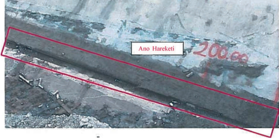
Şekil 7. Barajın Önyüzü Beton Anosunda Deforme Kısım
