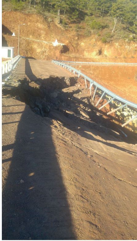
Şekil 3. Krette borulanma sonucu meydana gelen kayma
