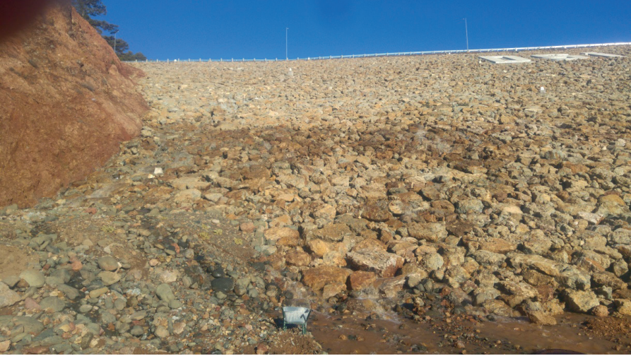
Şekil 2. Uşak Bahadır Barajı'nda dolgu gövdesi ile doğal zemin birleşiminde meydana gelen su kaçağı
