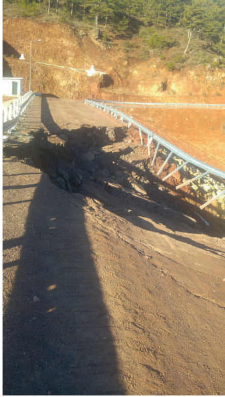
Şekil 3. Krette borulanma sonucu meydana gelen kayma
