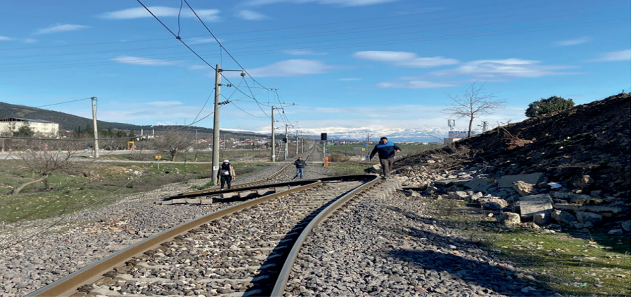
Şekil 5. 6 Şubat 2023 Kahramanmaraş Depremleri kaynaklı demiryolu hasarı
