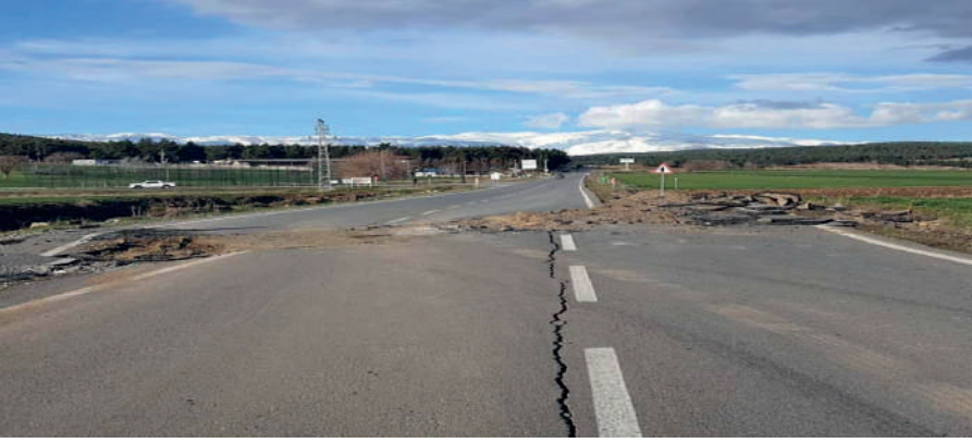
Şekil 6. 6 Şubat 2023 Kahramanmaraş Depremleri kaynaklı karayolu hasarı
