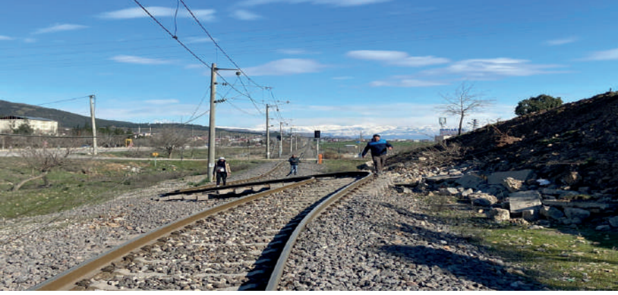
Şekil 5. 6 Şubat 2023 Kahramanmaraş Depremleri kaynaklı demiryolu hasarı
